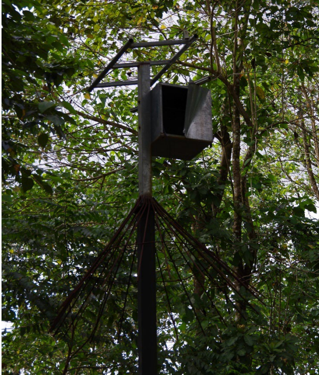
Restos de la instalación del panel solar
