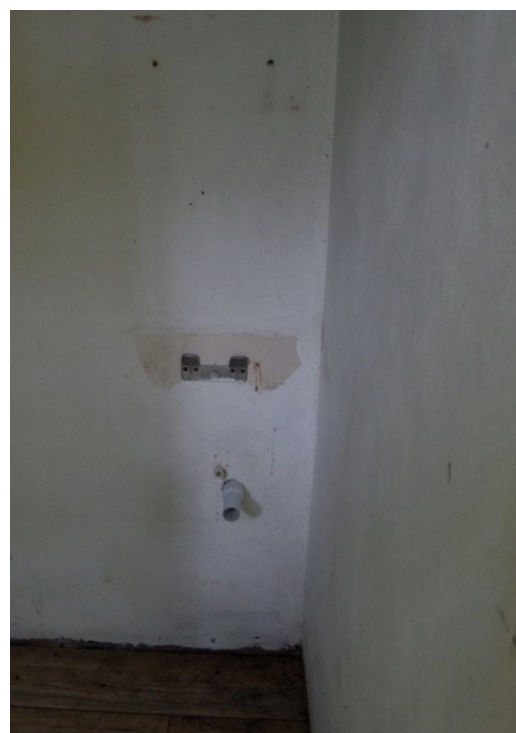
Robo de Lavatorio y otros
