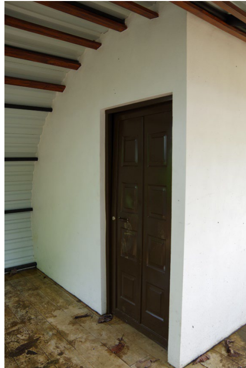
Daños materiales por intento robo
