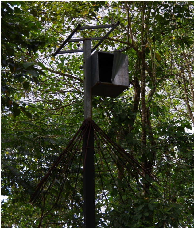
Restos de la instalación del panel solar
