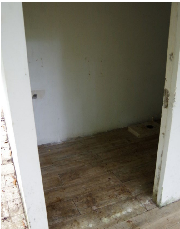
Robo de puerta y Servicio Sanitario
